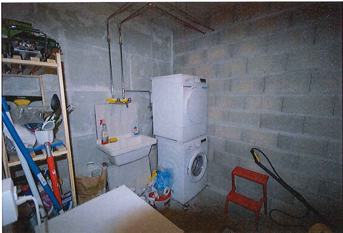
Buanderie au sous-sol
